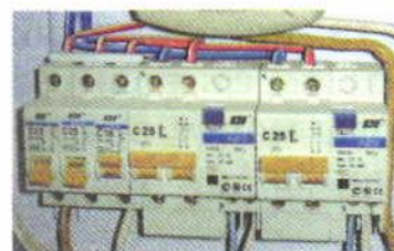
Рис. 91. Современный квартирный щиток с предохранителями
